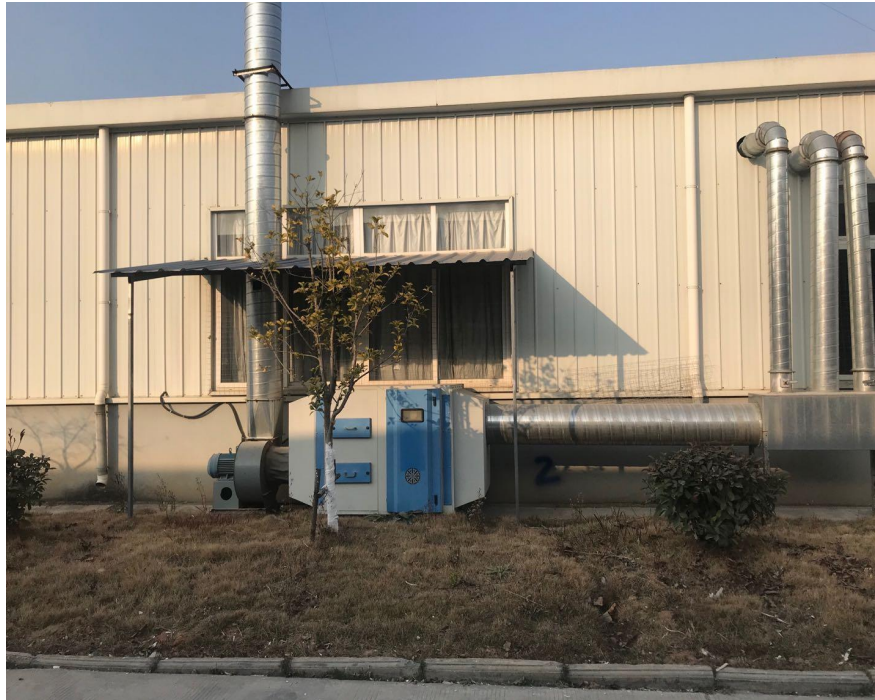
覆膜工序废气处理装置
