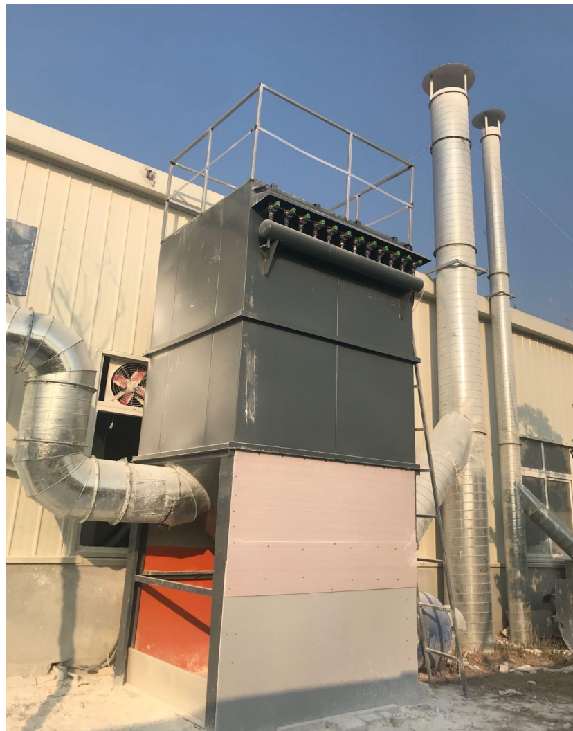
混料及破碎工序废气处理装置
